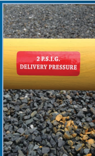
Ejemplo de la etiqueta utilizada para identificar tuberías con presión de suministro elevada.
